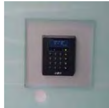
Forenklet tablå. Sirkelen viser at lederekkverket føres fram til tablå for ringeklokke og adgangskontroll.
